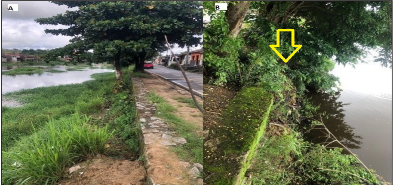
Figura 11 – (A) Muro de contenção de erosão fluvial; (B) Trecho do muro danificado
