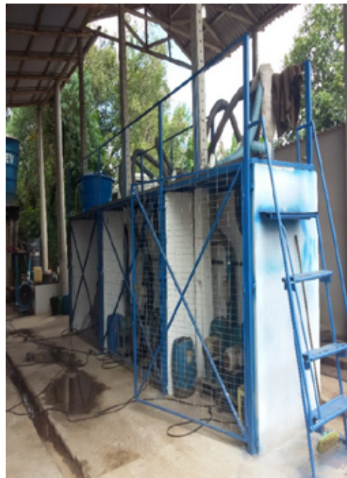
Figura 2b – Sistema de exaustão
