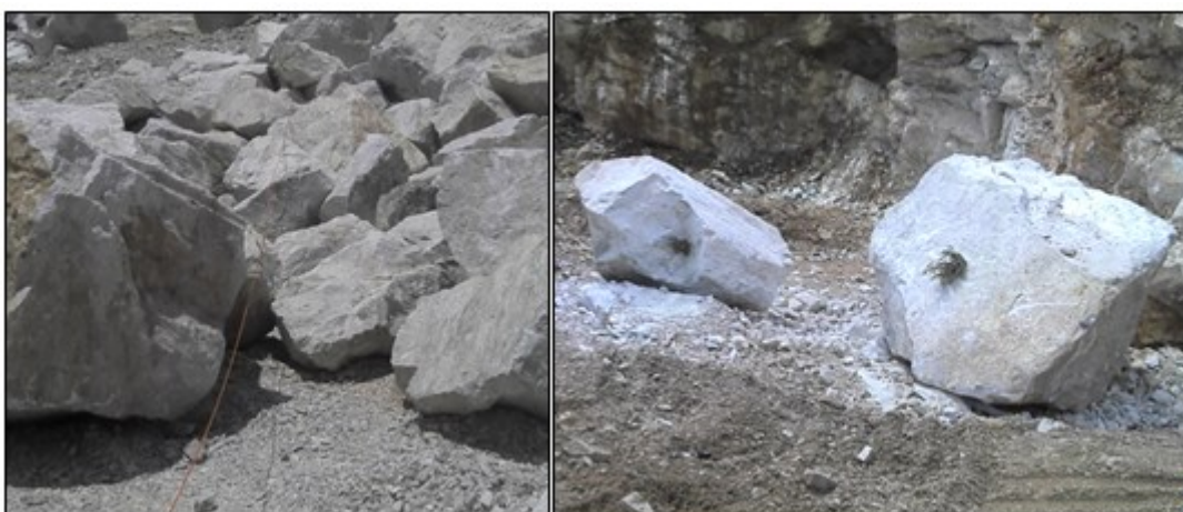
Figura 13 - Cordel exposto (à esquerda) e matacões marcados para desmonte secundário com os respectivos tampões.
