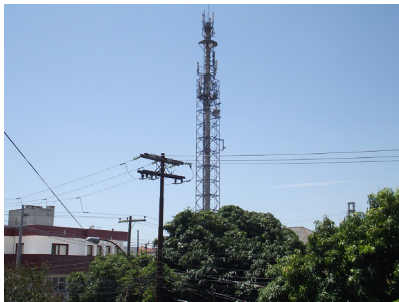
Figura 2 – Estação de Radiobase da Telefonia Celular - Bairro São Geraldo – Porto Alegre – Rio Grande do Sul.
