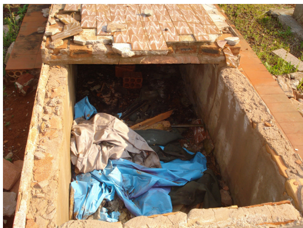
Figura 2. Sepultura quebrada com presença de resíduos em seu interior.
