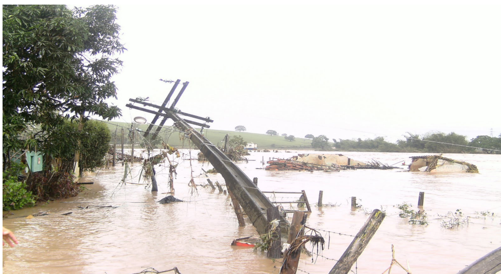
Figura4 - Poste de energia elétrica completamente destruída.
