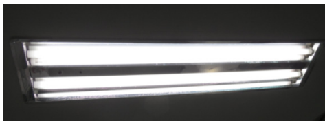
FIGURA 10 - Luminária do sistema de iluminação geral da sala de cirurgia 5 - Hospital B FONTE: arquivo próprio
