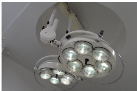
FIGURA 11 - Sistema de iluminação de tarefa da sala de cirurgia 5 - hospital B FONTE: arquivo próprio
