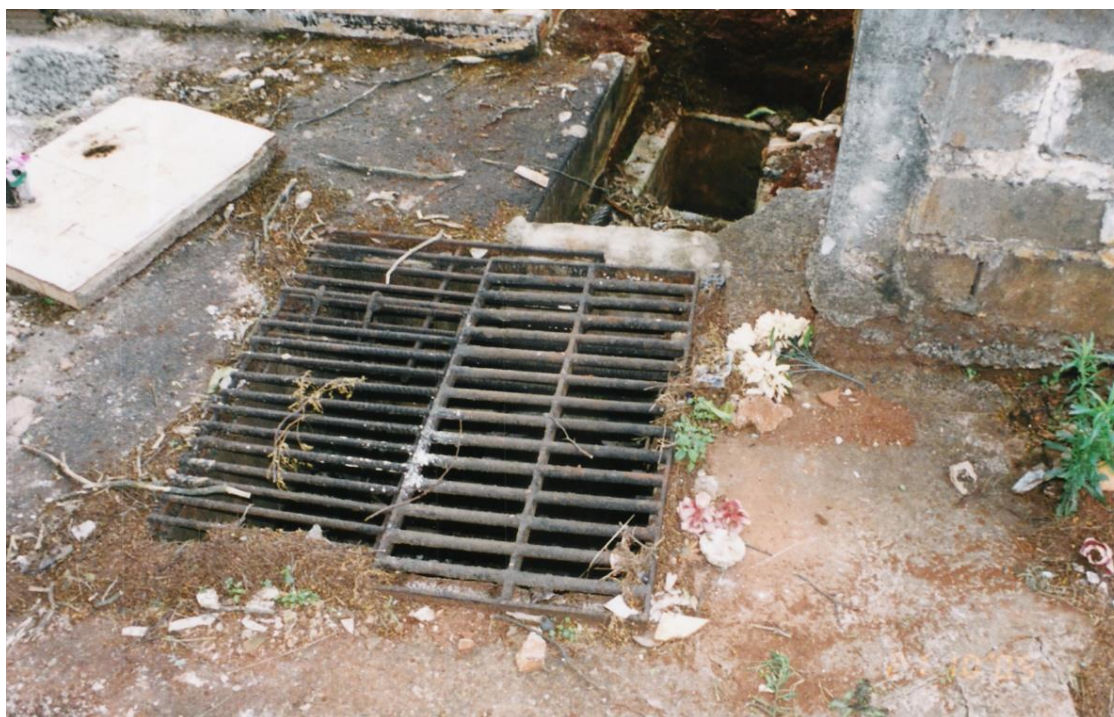
Figura 11. Condições da drenagem. Fonte: os autores
