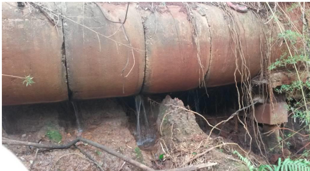
Figura 6 – Tubulação rompeu nas juntas dos tubos devido à insuficiência do sistema de drenagem a jusante do parque Alfredo Werner Nyffeler em Maringá – PR
