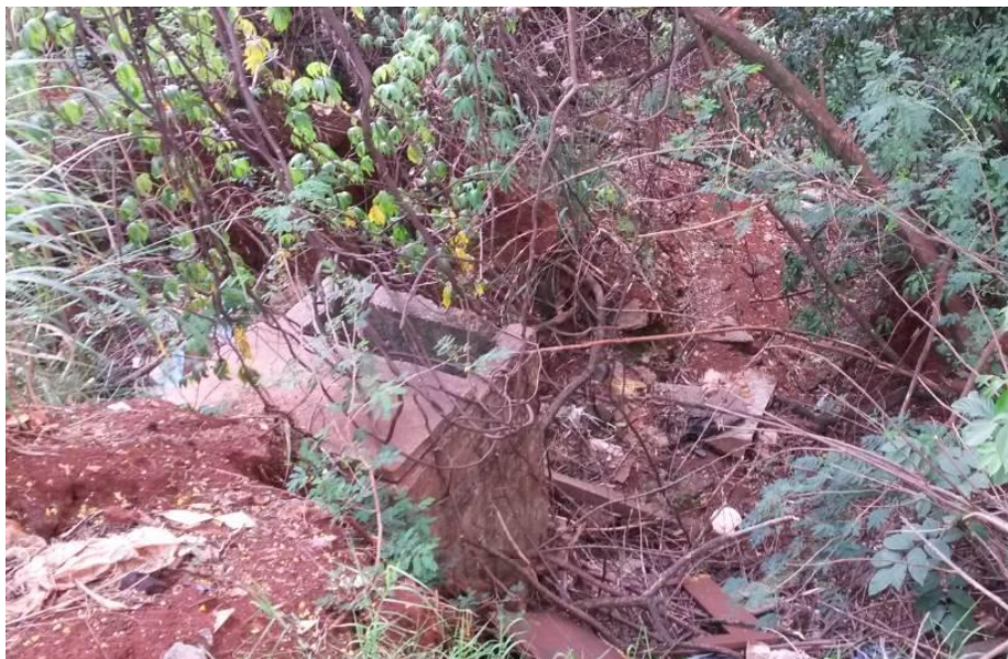
Figura 4 – Caixa de visita rompeu devido a insuficiência do sistema de drenagem jusante do parque Alfredo Werner Nyffeler em Maringá – PR
