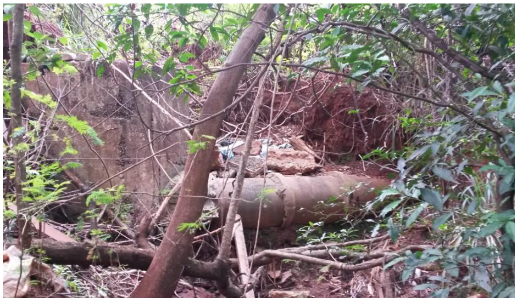
Figura 9 – Processo erosivo a jusante do parque Alfredo Werner Nyffeler em Maringá - PR
