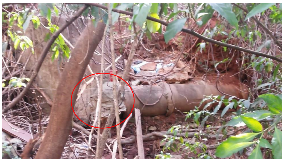
Figura 7 – Argamassa entre a caixa de passagem e tubulação rompidas devido a insuficiência do sistema de drenagem a jusante do parque Alfredo Werner Nyffeler em Maringá - PR
