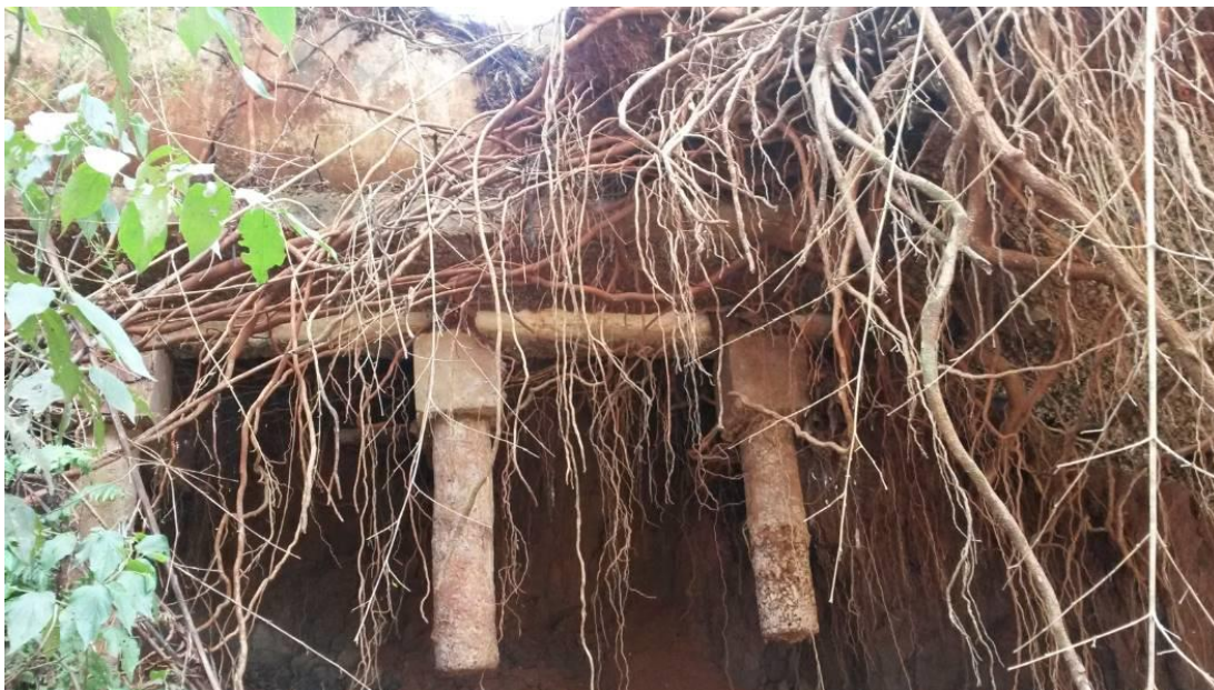
Figura 10 – Processo erosivo atingiu a fundação da estrutura a jusante do parque Alfredo Werner Nyffeler em Maringá - PR Fonte: Autor, 2014
