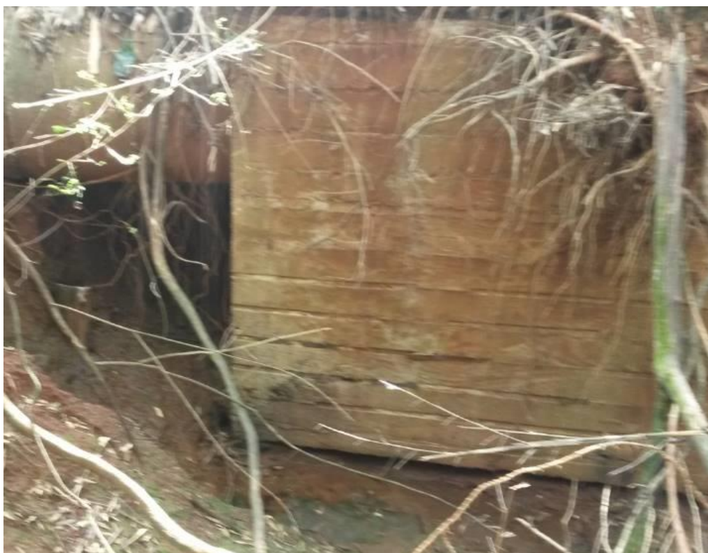
Figura 5 – Caixa de visita rompeu devido a insuficiência do sistema de drenagem jusante do parque Alfredo Werner Nyffeler em Maringá – PR
