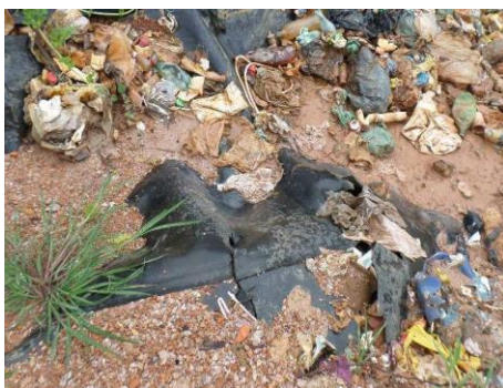
Fig. 3 - Rompimento da manta Fonte: Arquivo pessoal dos autores
