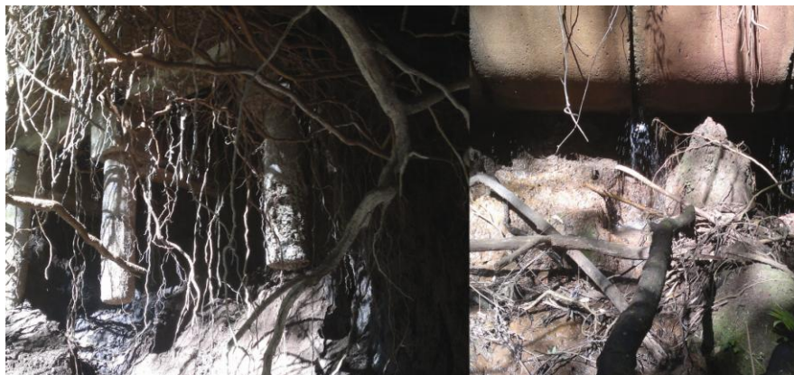
Figura 3 – Processo de erosão e sistema de drenagem no Ribeirão Morangueiro
