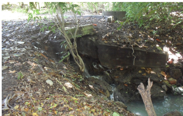
Figura 14 - Galeria de águas pluviais que verte para o Rio Cocó na Rua Monsenhor Salazar no Bairro São João do Tauape (março de 2011)
