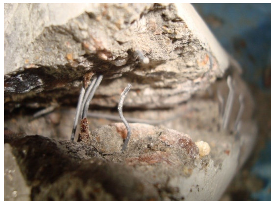
Figura 4 – Resultado do rompimento do concreto com adição de fibras de aço (Autor 2014).
