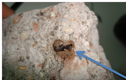
Figura 6 – Mancha devido à reação de corrosão das fibras em contato com o cimento (Autor 2014).
