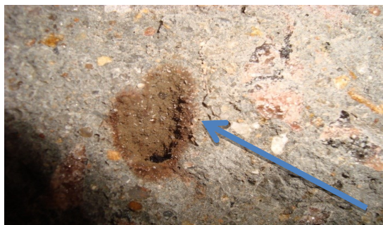
Figura 5 – Mancha devido à reação de corrosão das fibras em contato com o cimento (Autor 2014).
