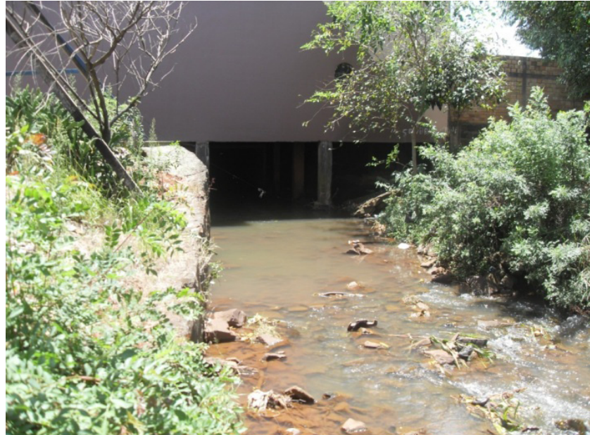
Figura 9 - Trecho com canalização fechada imediatamente abaixo de prédio no Lajeado Passo dos Fortes.
