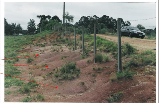
Foto 7 - Erosão 2 - perpendicular à estrada Fonte: acervo do autor, 2005.
