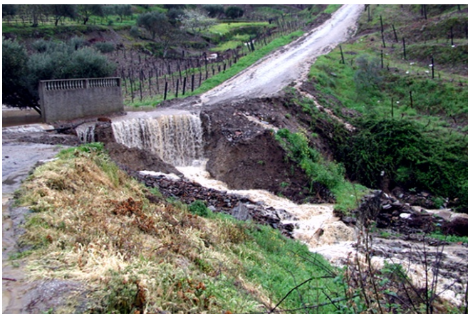
Foto 2 — Infraestrutura afetada pelo escoamento fluvial, demonstrando a sua inadequação a caudais relacionados com fenómenos extremos, na RDD.
