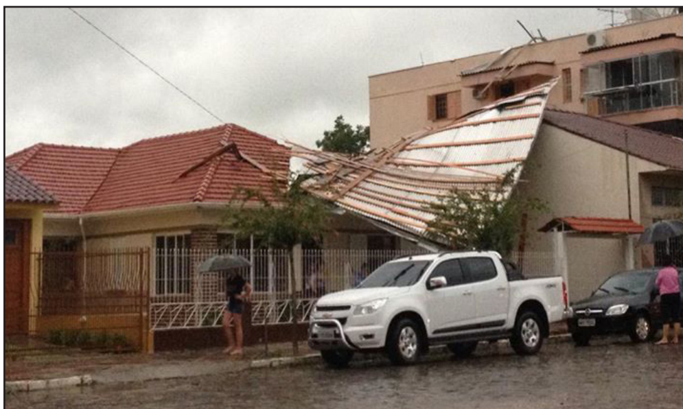
Figura 5 – Vendavais destelhando casas no município de Agudo em 2014
