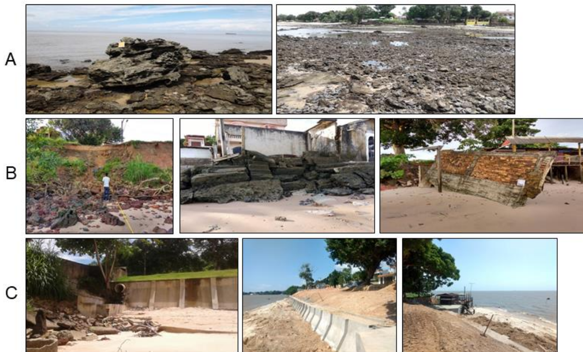
Figura 7 – Indicadores de erosão da orla Grande. A) parte norte: plataforma de abrasão e banco de cascalho; B) parte centro-sul: desmoronamento de falésias, destruição de muros, vigas, calçadas e escadarias; C) reconstrução do muro de contenção entre 2017 e 2018
