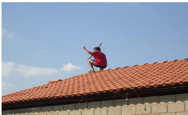
Figura 1: Instalação de antena de rádio em assentamento rural. Fonte: Fedel (2013).
