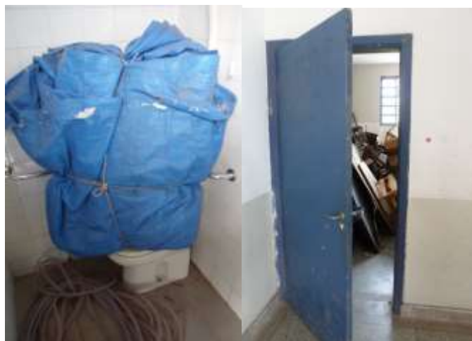
Figura 3 – Banheiros sem condições de uso
