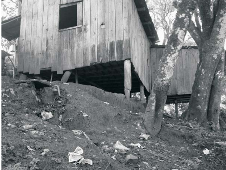
Figura 8. Fotografia da incidência de erosão linear provocada por concentração de água servida no terreno.
