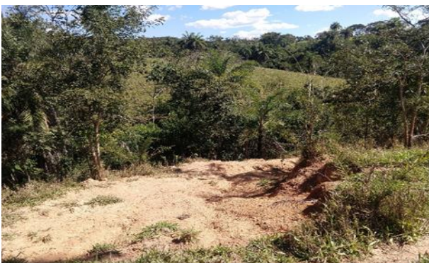
Figura 7 – Erosão (área II)
