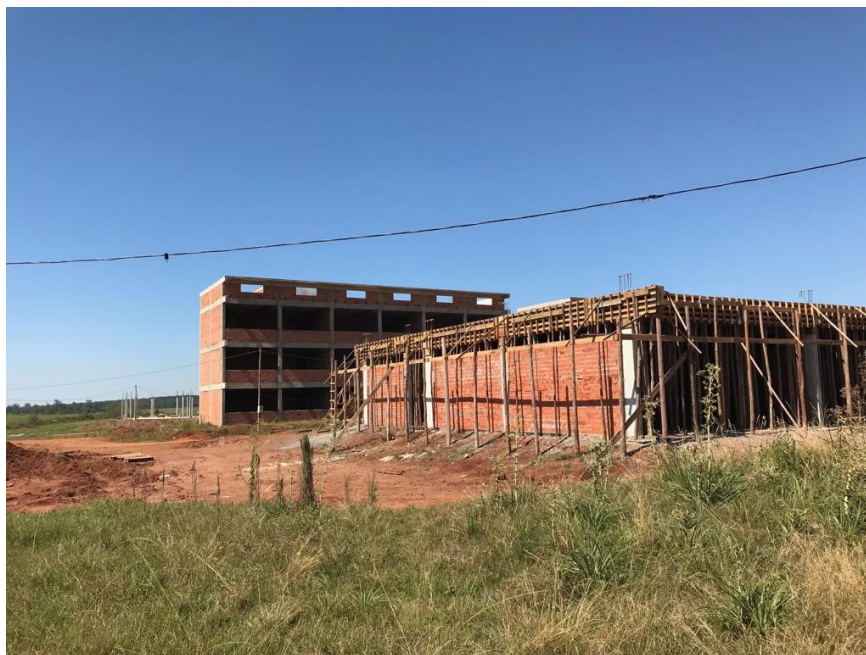
Figura 1 – Rede Provisória de Distribuição de Energia Elétrica
