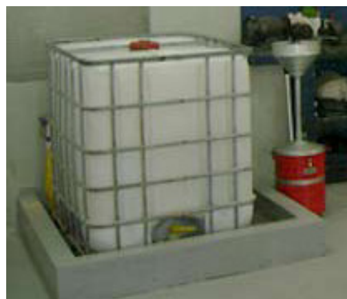
Figura 13. Container em bacia de contenção Fonte. ABRAMAC, 2008.
